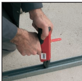
PERFILES TABIQUERIA SECA
